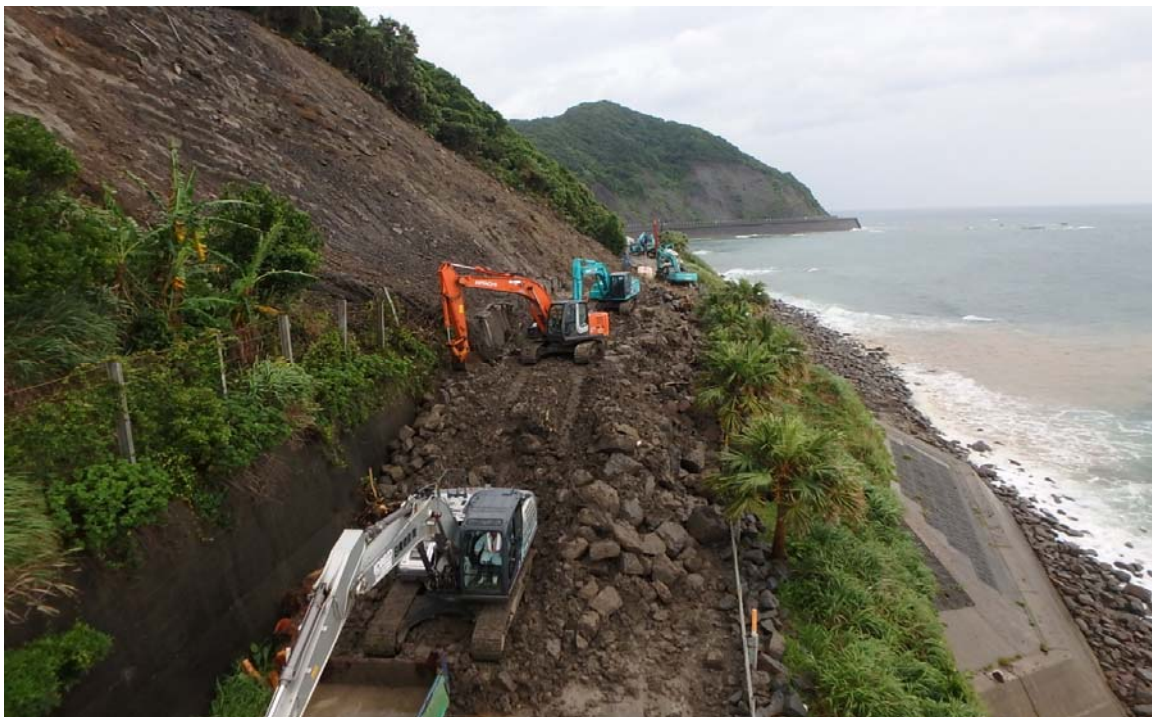
《土砂撤去状況③》6月25日7時頃
