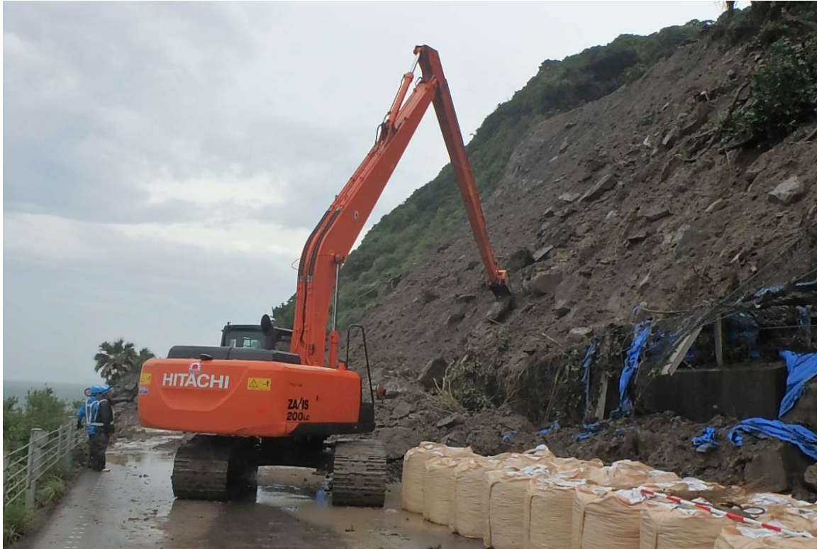
《土砂撤去状況②》6月25日7時頃
