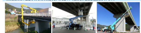
橋梁点検車による点検 リフト車による点検 高所作業車による点検
