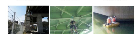
足場設置による点検 特殊高所技術による点検 小型船舶を使用した水上での点検
