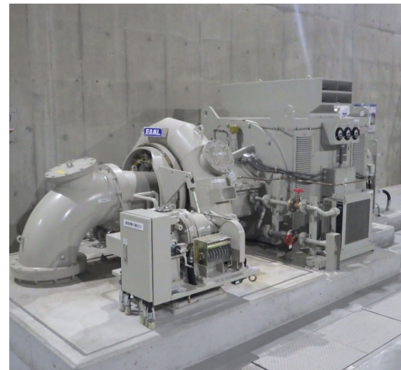
写真3-1 水力発電設備
