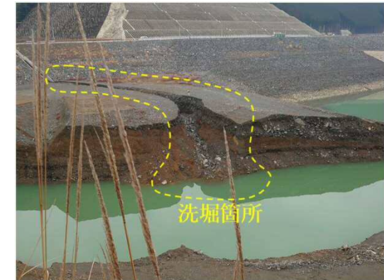
湖岸の洗掘の状況(R5.1月)
