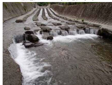
取水堰下流水路の状況(R5.5月) ※洗掘により根固ブロックと落差が生じている
