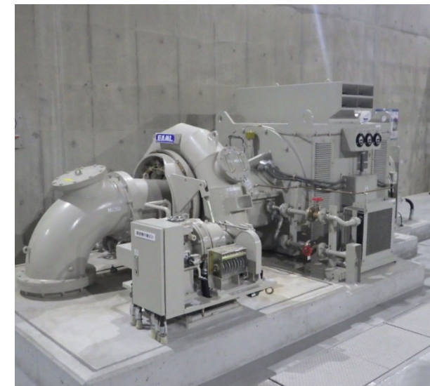
水力発電設備
