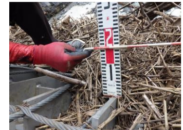
塵芥堆積状況 (令和6年8月撮影)
