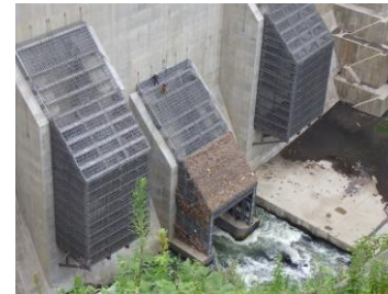
塵芥堆積状況 (令和6年8月撮影)
