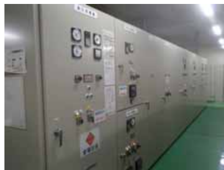
電気設備 (他ダム事例)
