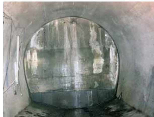
転流工閉塞状況（他ダム事例）
