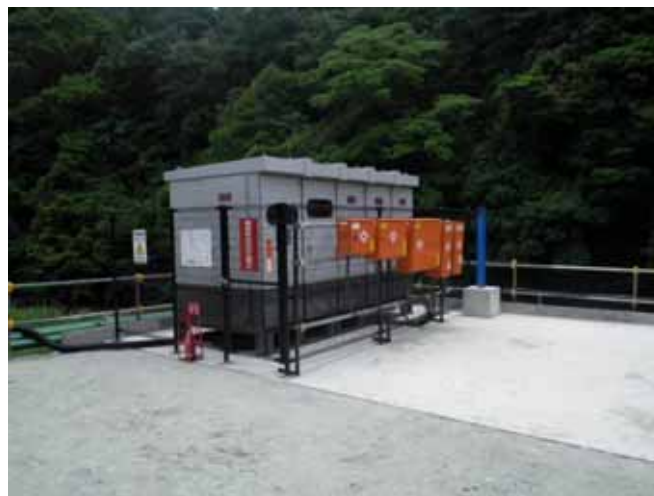
電力設備（他ダム事例）
