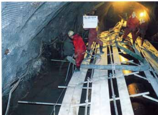
転流工閉塞状況（他ダム事例）
