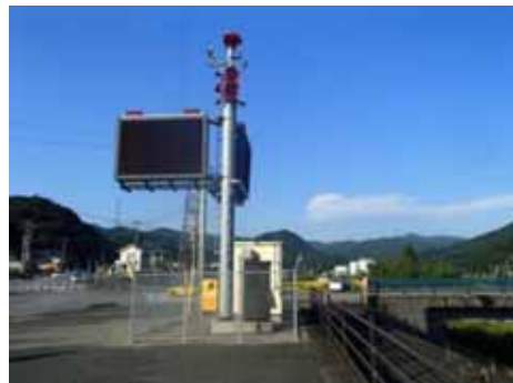
警報設備 (他ダム事例)
