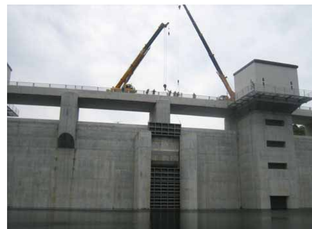
試験湛水ゲート設置状況(他ダム事例)
