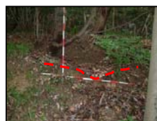
② 切土のり面上部のクラック(h=0.3m)
