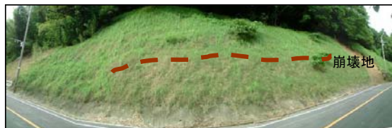
③ 斜面中腹のはらみ出し
