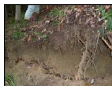
① 滑落斜面側部のクラックh=1.2m
