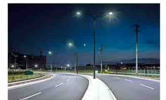
道路照明のLED化
