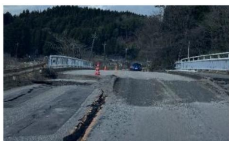
国道249号の橋梁段差
