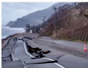
国道249号の道路亀裂
