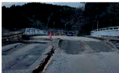
国道249号の橋梁段差
