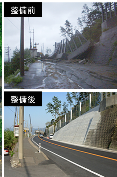
※H17.9.6台風14号に伴う豪雨等のため法面崩壊
