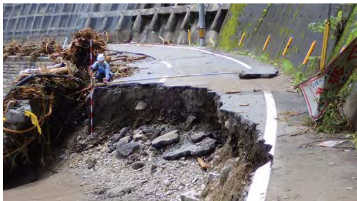
朝倉市 福岡県道509号塔ノ瀬十文字小郡線 佐田川 被災調査
