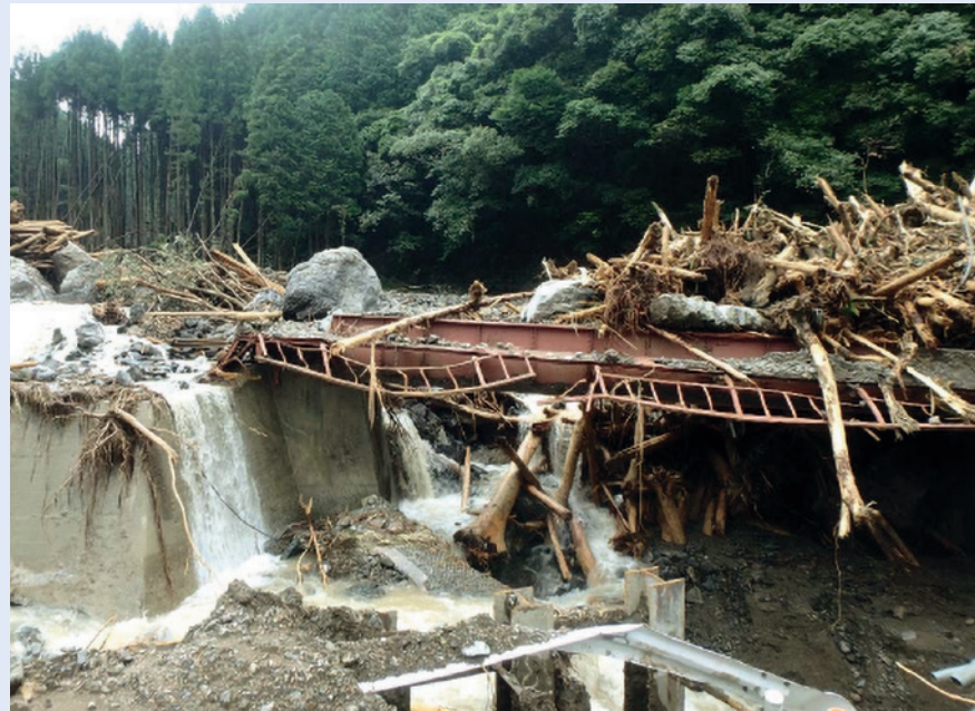
JR肥薩線(坂本町):橋梁の被災
