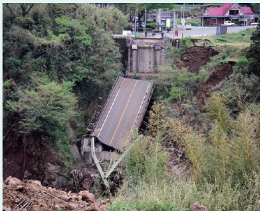
阿蘇大橋落橋—被災のシンボル
