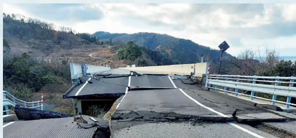
国道249号 鳥川橋の被災状況
