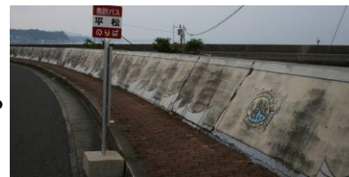
塗装が剥がれていたパラペット
