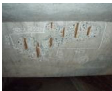
主桁部はく離発生状況
