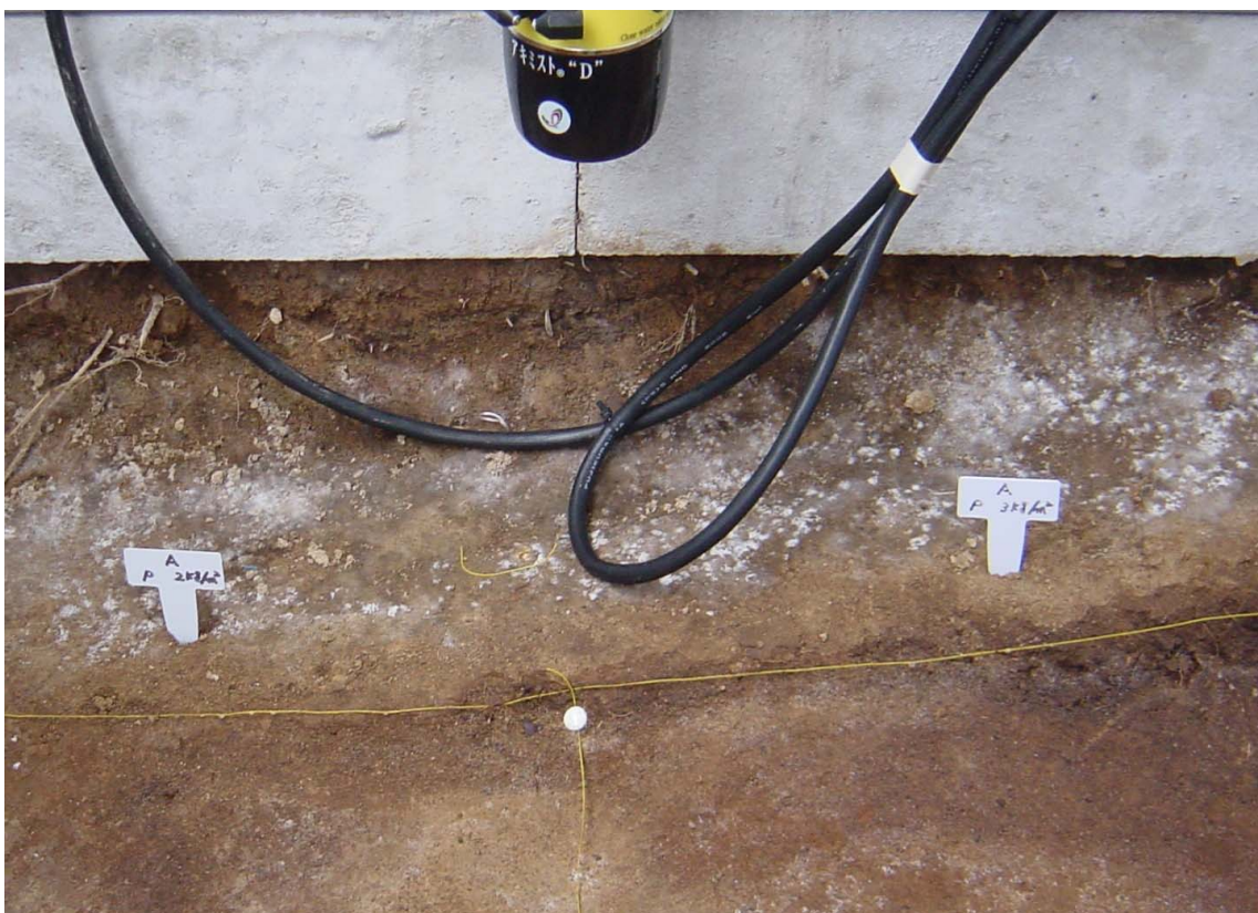
土壌表面に発生したカビ
