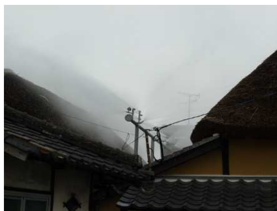
写真4 放水中の散水設備
