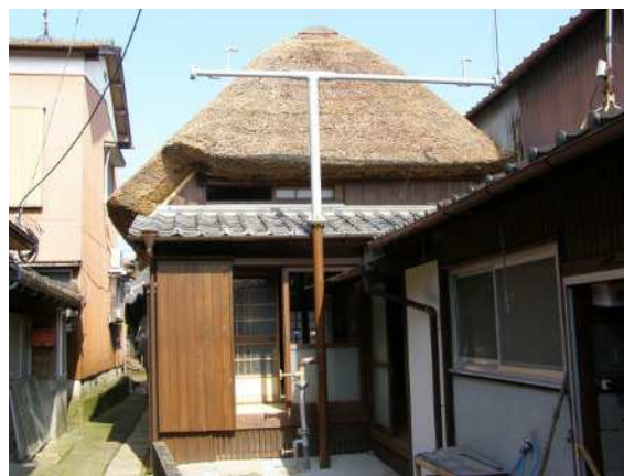
写真6 独立式の散水設備
