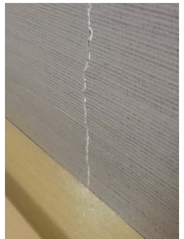
写真6 宿泊した部屋の壁に発生したクラック及びモルタル片
