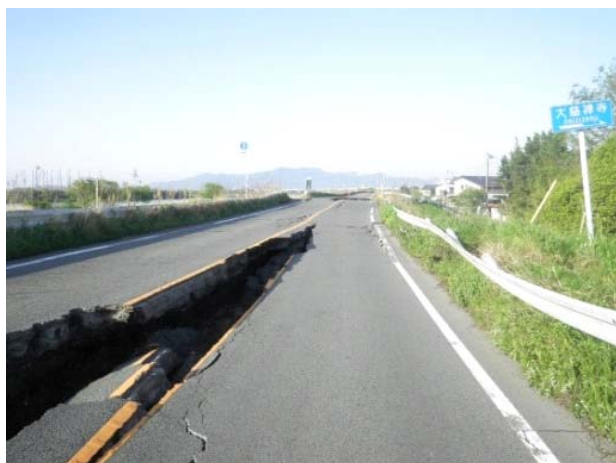
写真－１ 緑川右岸 ８ ｋ ９ ０ ０ 付近
