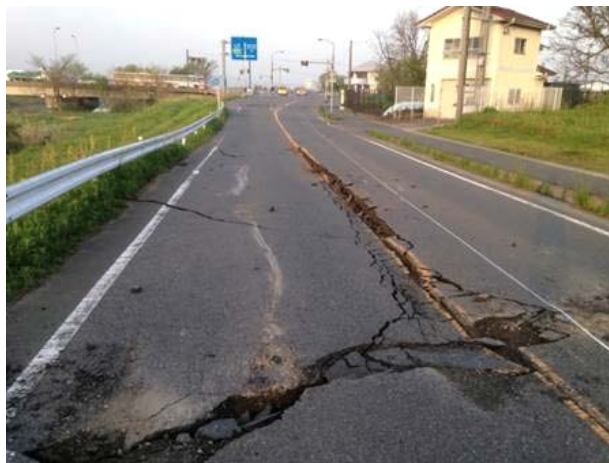
写真－２ 加勢川右岸 ９ ｋ ８ ０ ０ 付近
