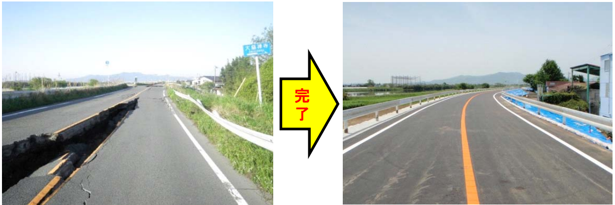
写真－4 緑川右岸8k900 被災状況（左）、緊急復旧状況（右）
