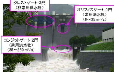
図-2 耶馬溪ダムのゲート設備
