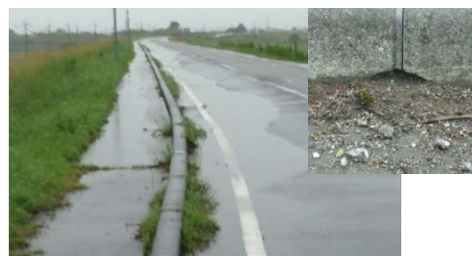
図 3-7 水たまりと排水孔目詰まりの状況
