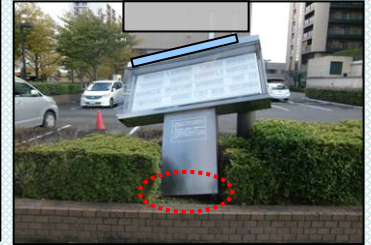
掲示板 (転倒の危険)
