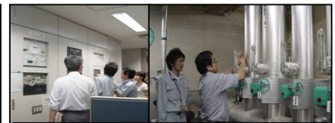
中央制御盤、圧力計の数値の確認
