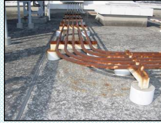
電気配管 (漏電の危険)
