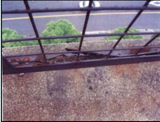
手すり (落下の危険)
