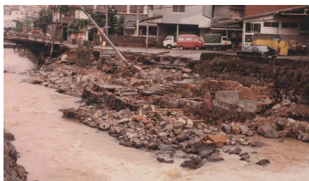
激しい流れでこわれた道路 (写真：長崎県河川課提供)
