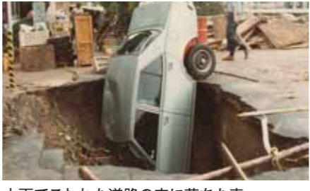
大雨でこわれた道路の穴に落ちた車 (写真：長崎県河川課提供)
