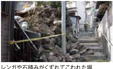
レンガや石積みがかずれこわれた塀 (写真：福岡市提供)
