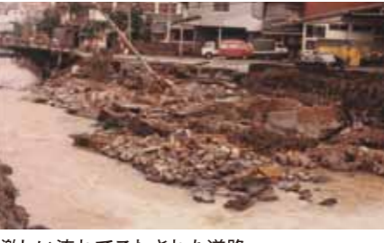
激しい流れでこわされた道路 (写真：長崎県河川課提供)
