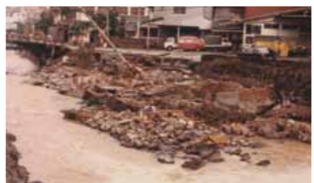
激しい流れでこわされた道路 (写真：長崎県河川課提供)
