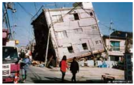
大きなゆれでこわれたビル (写真：災害写真データベース提供)
