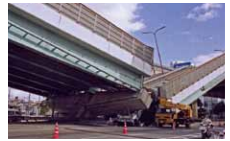
こわれた高速道路 (写真：西宮市災害写真情報館提供)
