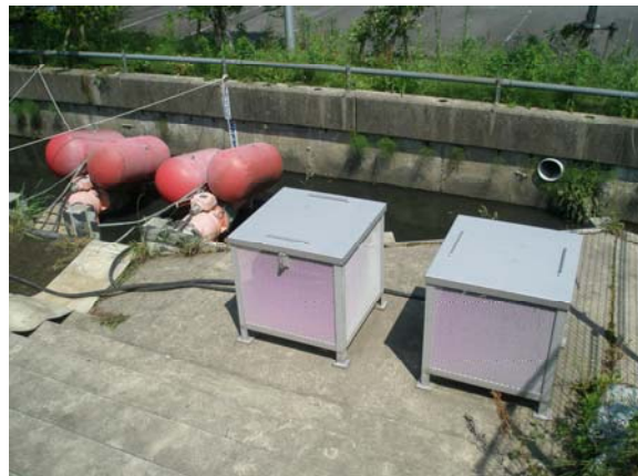
船越町排水路（3号車）
