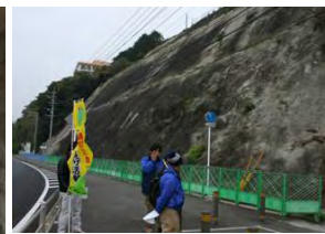
コンクリート吹き付けにクラ ックがあり強度等の調査が実 施される
