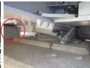
写真-6 支承の破損の状況
