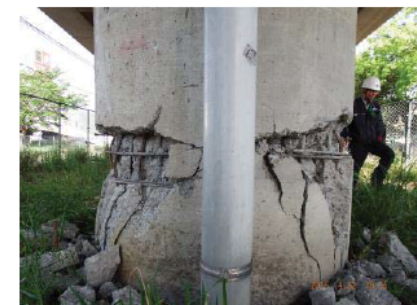
写真-7 段落し部の損傷 ちゅうおうせんりつきょう 市道(1-3)中央線・中央線陸橋
