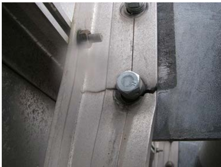
き裂損傷 (車両衝突)
