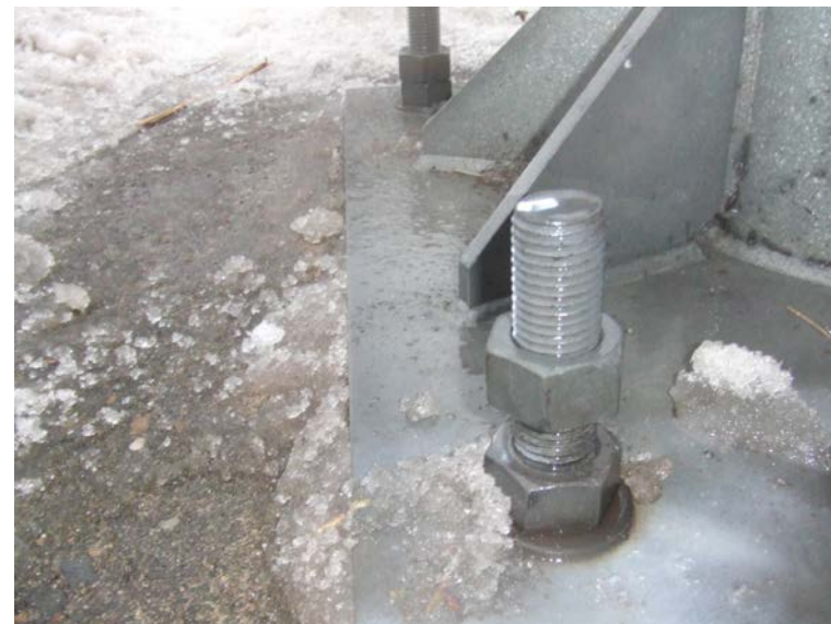
ボルトの緩み (施工不良)
