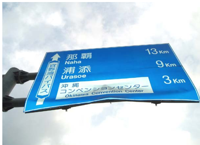
異常変形 (車両衝突)
