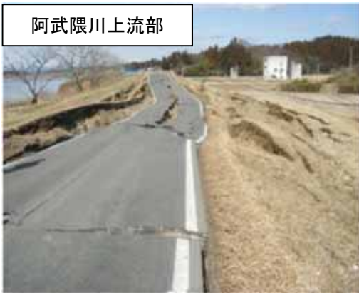
地震による堤防の被災状況
