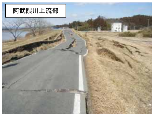
地震による堤防の被災状況
