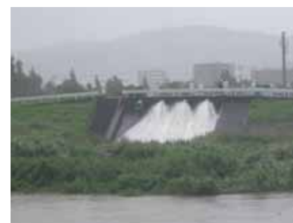
排水機場排水状況（H21.7）
