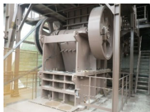
補助破碎設備
