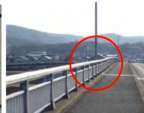
▲中央ヒンジ部の垂れ下がり
