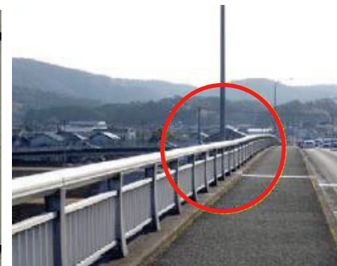
▲中央ヒンジ部の垂れ下がり
