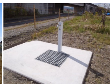
延岡市が設置した水道設備
