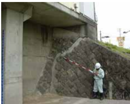
写真 2-1-1 クラック 状況
