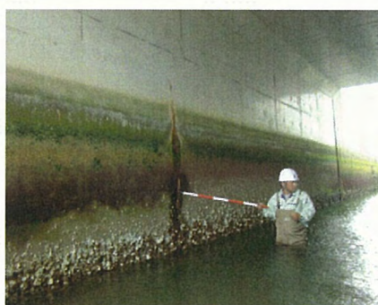
写真 2-1-1 鉄筋露出状況
