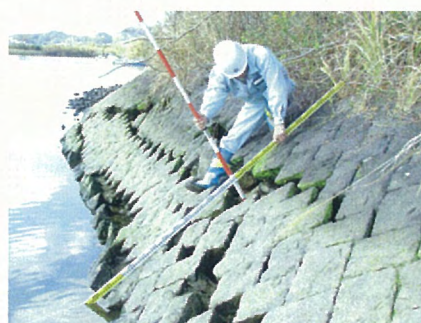
写真 2-1-2 護岸崩落状況
