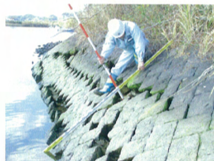
写真 2-1-2 護岸崩落状況
