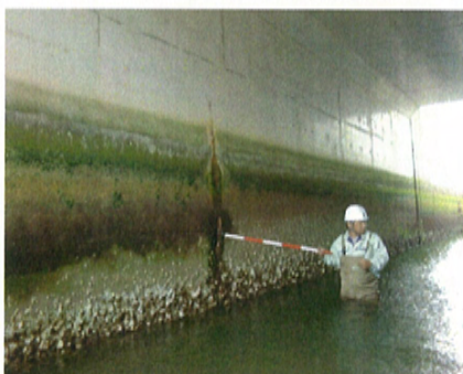
写真 2-1-1 鉄筋露出状況
