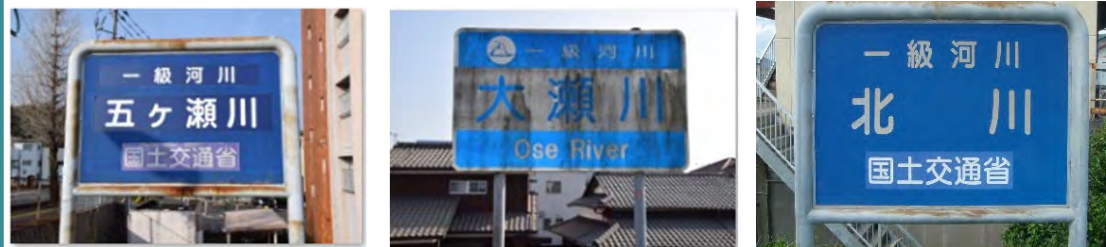
老朽化した河川標識の現状
