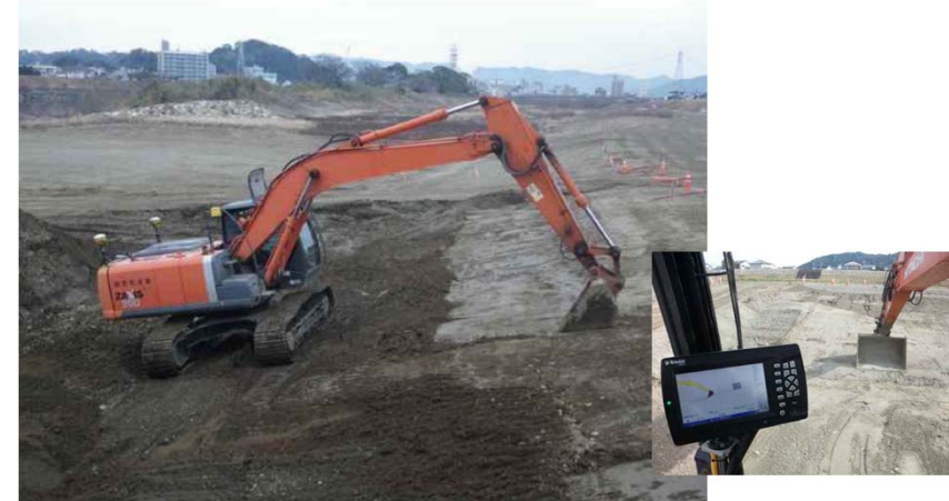
グレートコントロールシステム※(新技術)の活用
