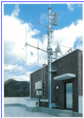
新庁舎屋上屋外子局
