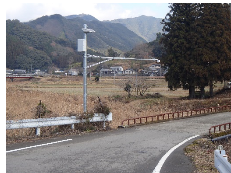
危機管理型水位計設置例： 多良田川 猪之島橋 (北川町)
