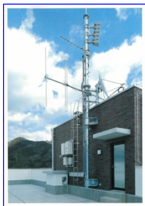
新庁舎屋上屋外子局
