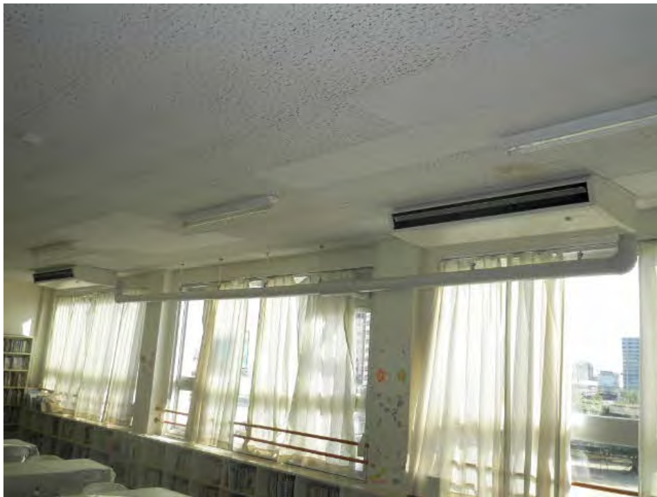
空調整備後の特別教室（岡富小学校）
