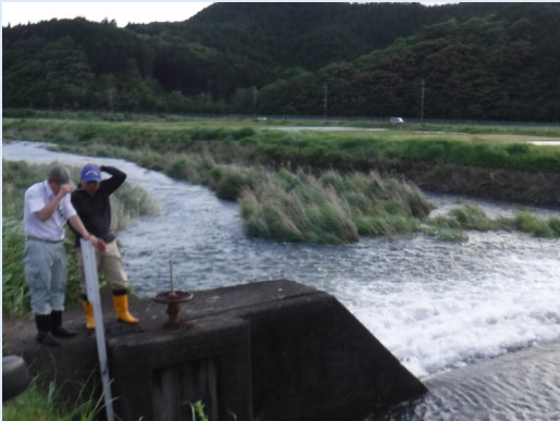
南浦土地改良区(延岡市)
