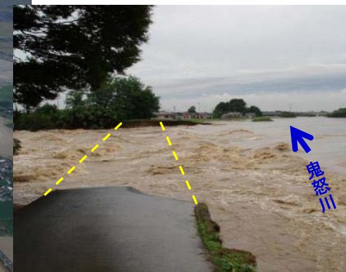
被災状況(拡大写真)
