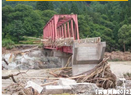
倒壊した只見線橋梁(福島県只見町矢木沢地区)
