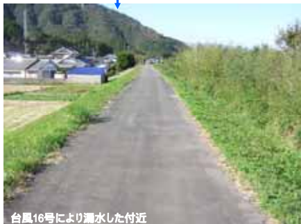
台風16号により漏水した付近
