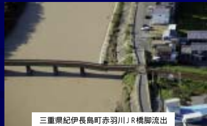
三重県紀伊長島町(赤羽川)R橋脚流出
