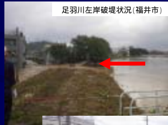
足羽川左岸破堤状況(福井市)
