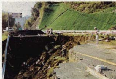
▼国道218号 日之影町深角地区 路肩崩壊(全面通行止め)
