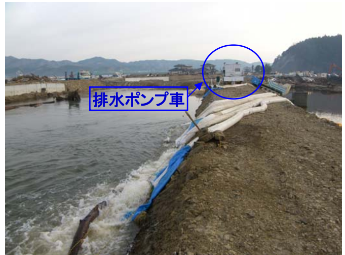
宮城県石巻市釜谷地区での排水状況②
