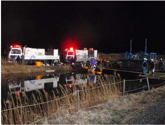
宮城県石巻市井内地区での設置状況
