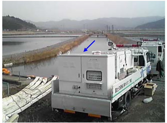
宮城県石巻市井内地区での排水状況
